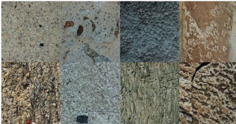
La richesse des textures et couleurs des enduits ruraux, dont la composition du matériau ou le travail de l'outil fait varier les nuances. Source : Tiffanie Le Dantec. « Les façades enduites au plâtre d'Île-de-France. Le déclin du plâtre extérieur, du XVIIe au XXe siècle. »
